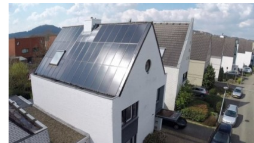
integratie PV panelen in architectuur dak
