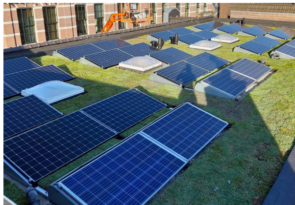
Zonnepanelen icm groen dak
